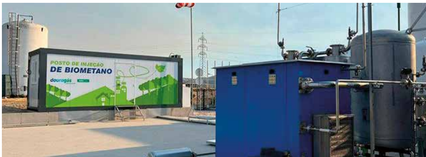
Figura 4.33. Posto de injeção de biometano da empresa Dourogás, em Urjais, Mirandela (Fonte: Dourogás 10 ).
